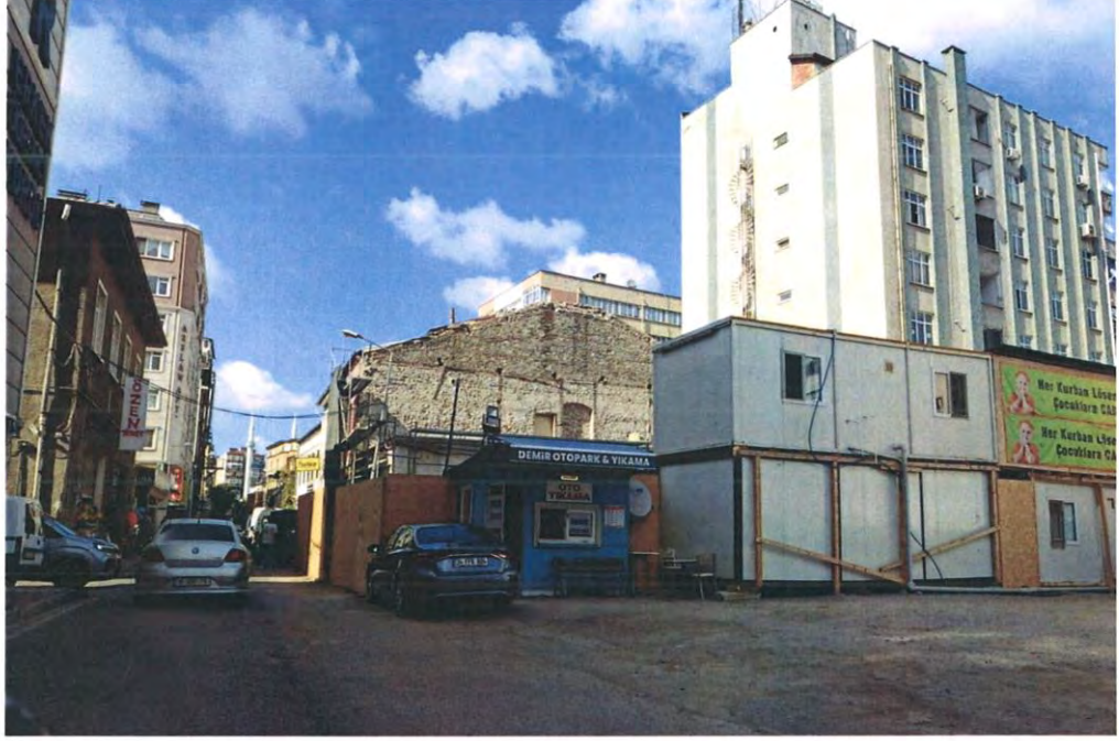
Şu an mevcut hali çatı ve 1. Kat tamamen kayıp
