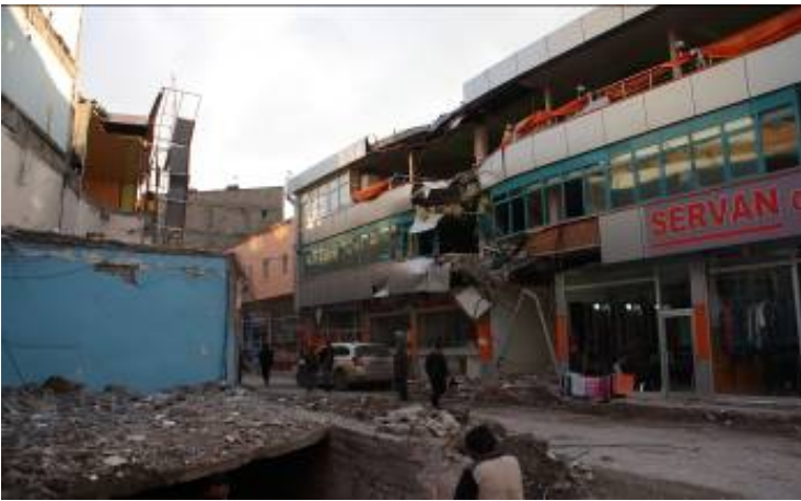
Van Merkezinde Yıkılarak Devrilen Otel Binasından Hasar Gören İş Merkezi
