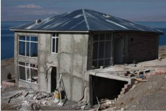
Amik Kalesi Yakınlarındaki Yeni Yerleşme Alanlarının Hasar Durumları
