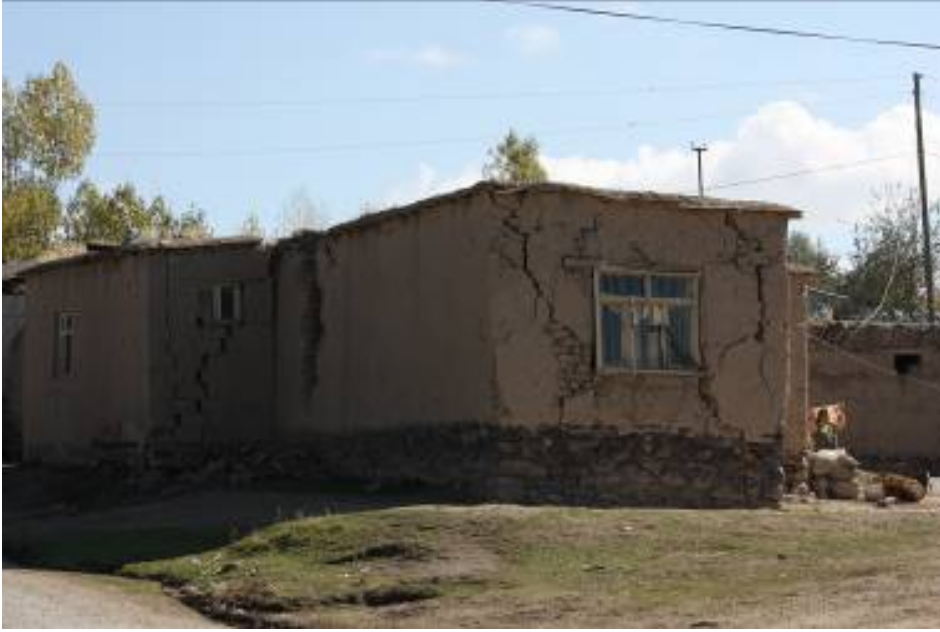
Döşeme Mezrası'nda Hasar Gören Kerpiç Ev
